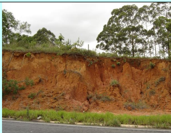
Figura 224 - Processo erosivo instalado em latossolo às margens da MG 050, causado por obras que deixaram o perfil muito verticalizado e susceptível à fatores erosivos, Cachoeira do Areião, Formiga- MG.
